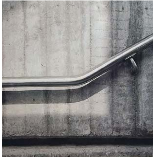
↑ Teräskaide kiinnitettynä lautamuottibetonipintaiseen seinään. Asemilla pintamateriaalien käyttö on tarkoituksella vähäistä. Kuva julkaistu teoksessa Helsingin Kaupungin Metrotoimisto, Helsingin metro 1982.
