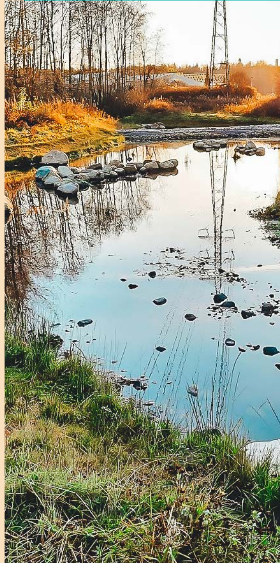
Raide-Jokerin linjan pohjoispuolelle Mustapuron yläjuoksulle rakennettiin tulva-allas, joka tasaa virtaamia ja laskeuttaa kiintoainesta.
